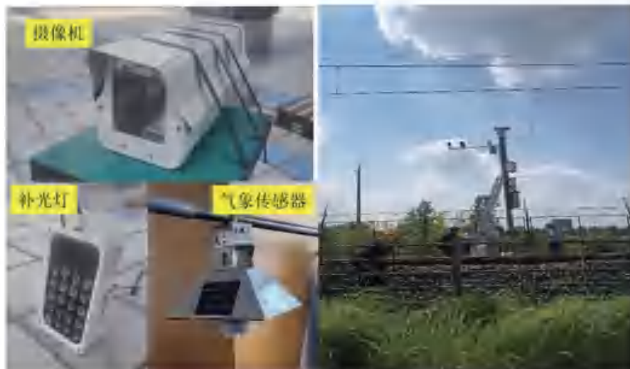
地铁接触网观测设备及实地安装
